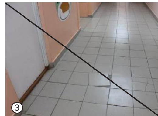
3. Керамогранитная плитка не лучший материал при капитальном ремонте общественных зданий, особенно старого фонда. Она часто выглядит небрежно и рушится из-за толстых неровных швов и низкокачественной стяжки. Швы плитки быстро пачкаются и требуют постоянного ухода, что бывает проблематично обеспечить. Если вы все же выбираете этот материал, то делайте укладку с минимальными швами, покупайте качественную плитку, рассчитанную на общественные здания большой проходимости, проверяйте соблюдение технологии укладки. Все это нужно учесть в закупочной документации
